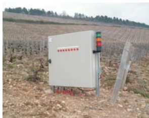
armoire de distribution électrique
